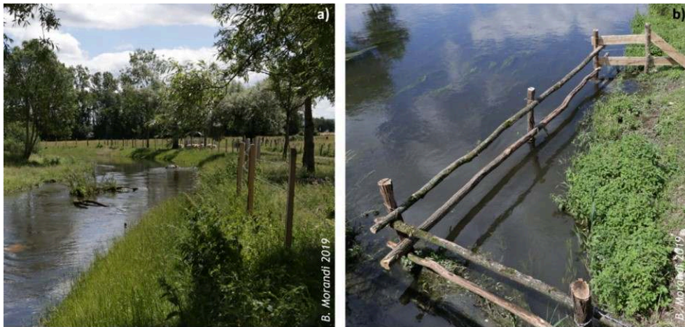
Clôture (a) et abreuvoir (b) réalisés pour compenser les effets des travaux de RCECE sur les parcelles agricoles riveraines
